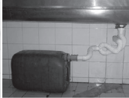
Figura 1.12 Sistema de coleta de urina nos mictórios de banheiros masculinos
