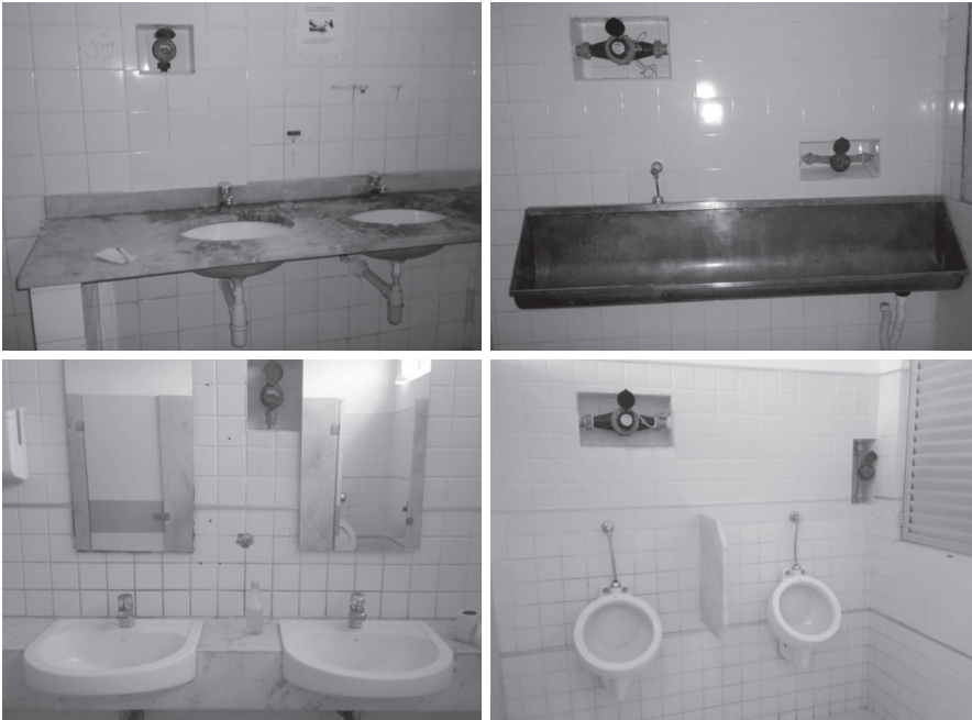
Figura 2.27 Hidrômetros instalados nos sanitários da EPUFBA (acima banheiro não modificado, abaixo banheiro modificado)
