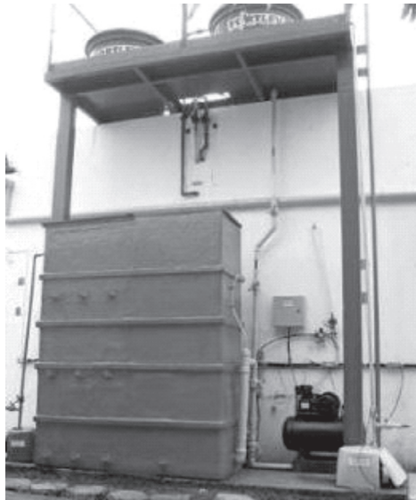
Figura 4.22 Vista geral do sistema de reúso de águas cinzas da UFES
